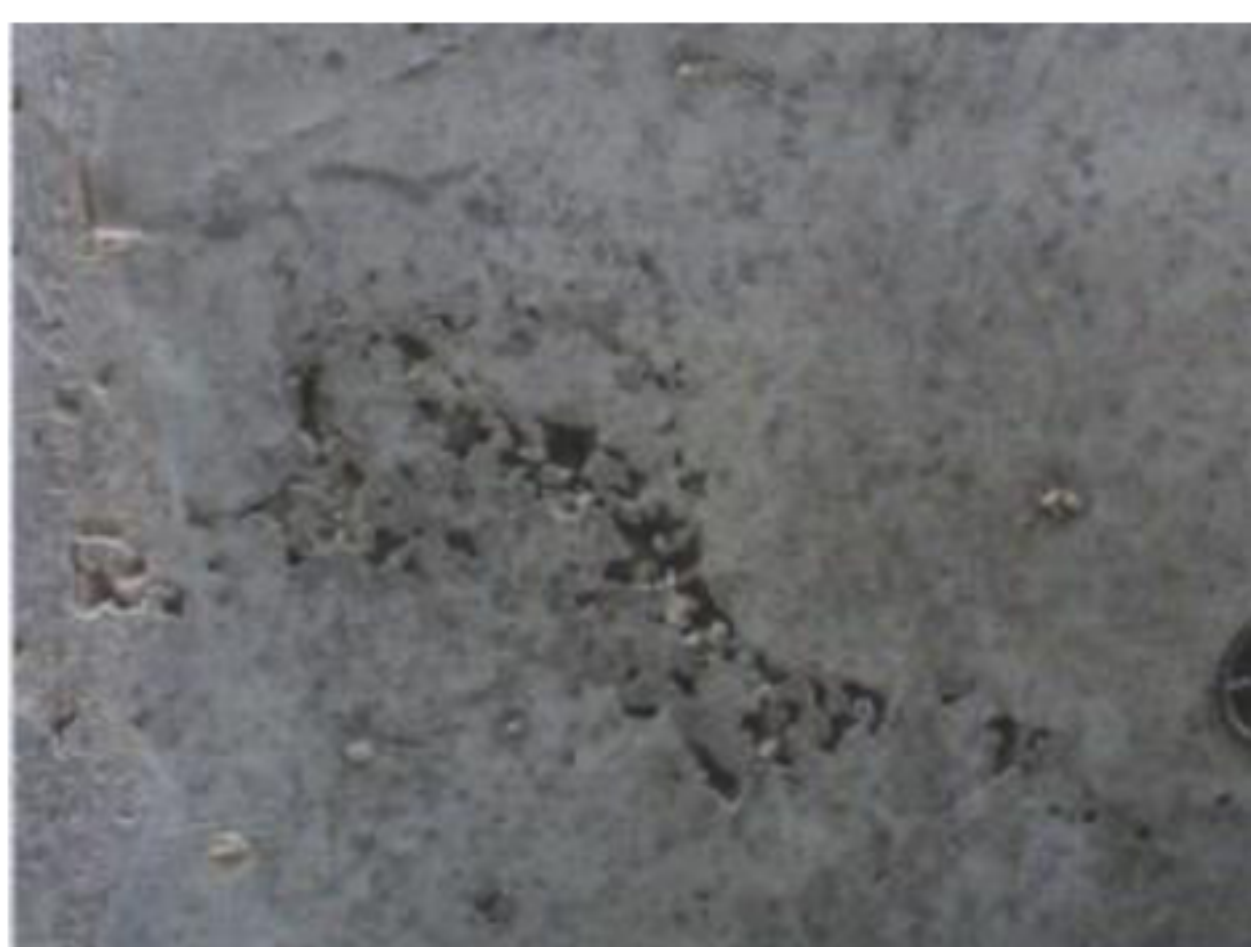
Рисунок 26. Непровибрированные участки с образованием каверн под металлической балкой
