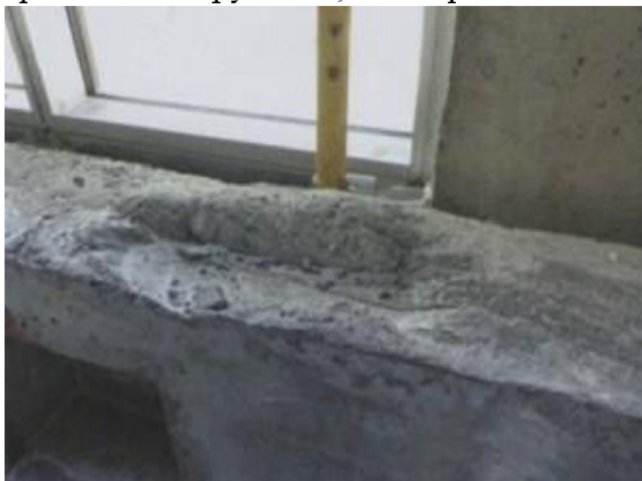
Рисунок 6. Наплывы бетона с нарушением геометрии конструкции
