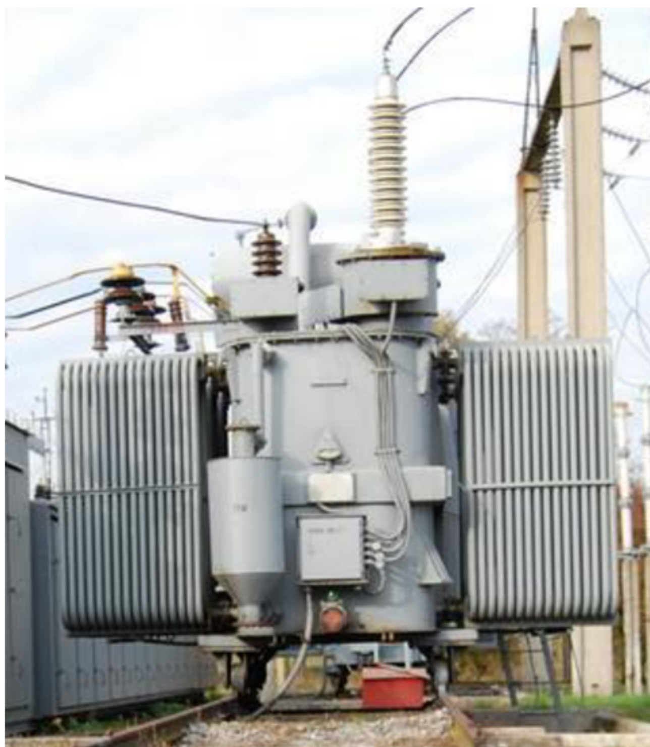
Рисунок 5 Силовой трансформатор подстанции
