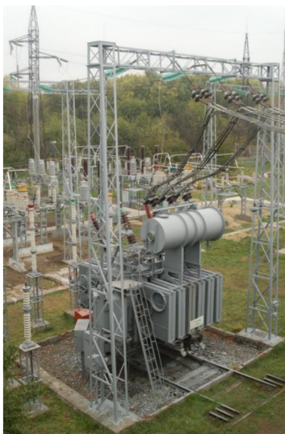
Рисунок 6 Силовой трансформатор и открытое распределительное устройство подстанции
