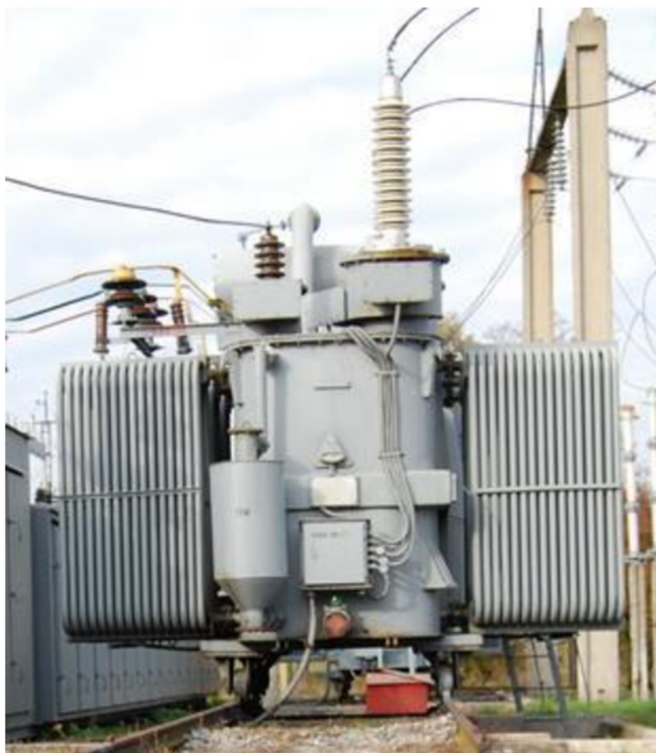
Рисунок 5 Силовой трансформатор подстанции
