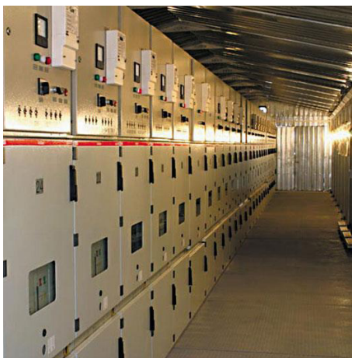
Рисунок 4 ЗРУ комплектующее шкафом КРУ
