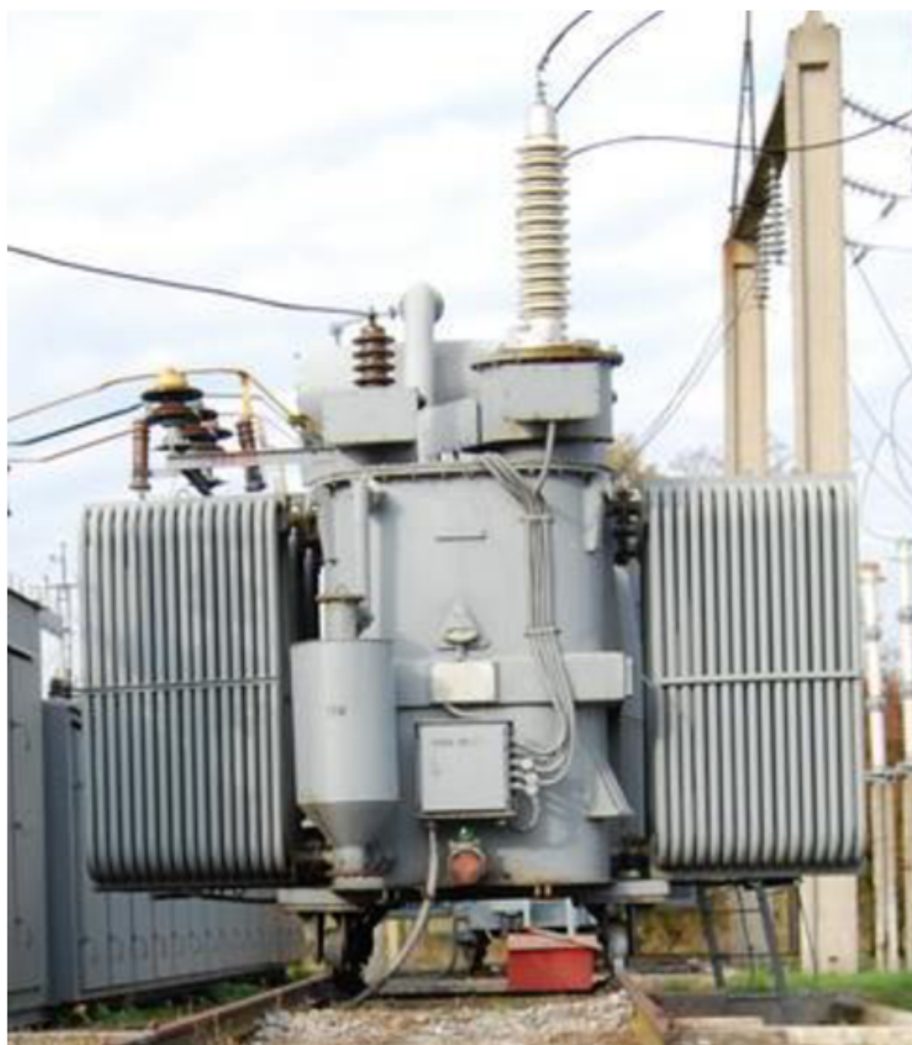
Рисунок 5 Силовой трансформатор подстанции
