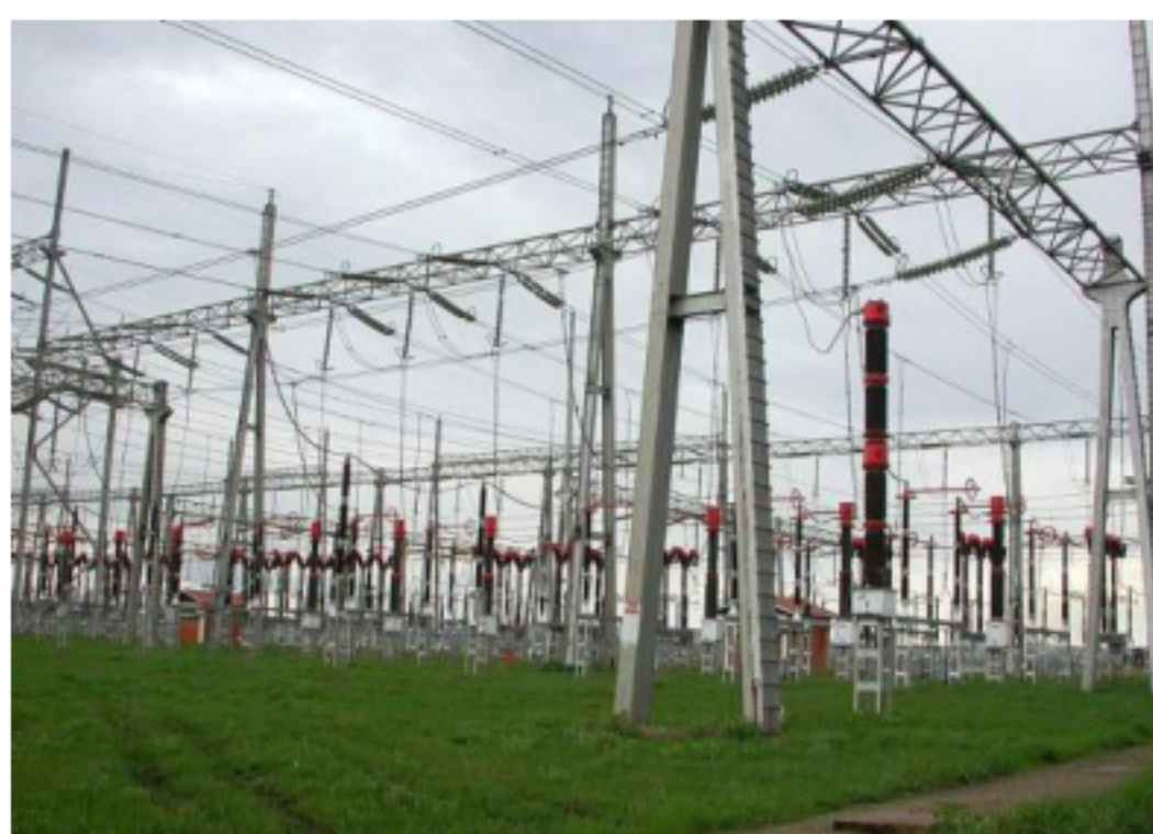
Рисунок 2 –Открытые распределительные устройства Закрытые распределительные устройства
