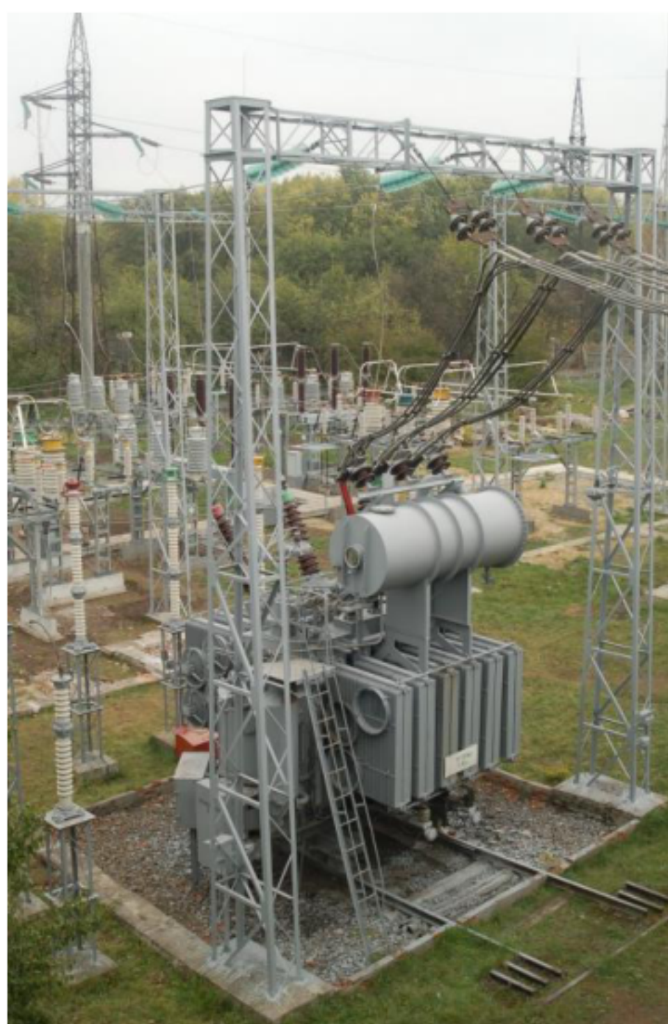
Рисунок 6 Силовой трансформатор и открытое распределительное устройство подстанции
