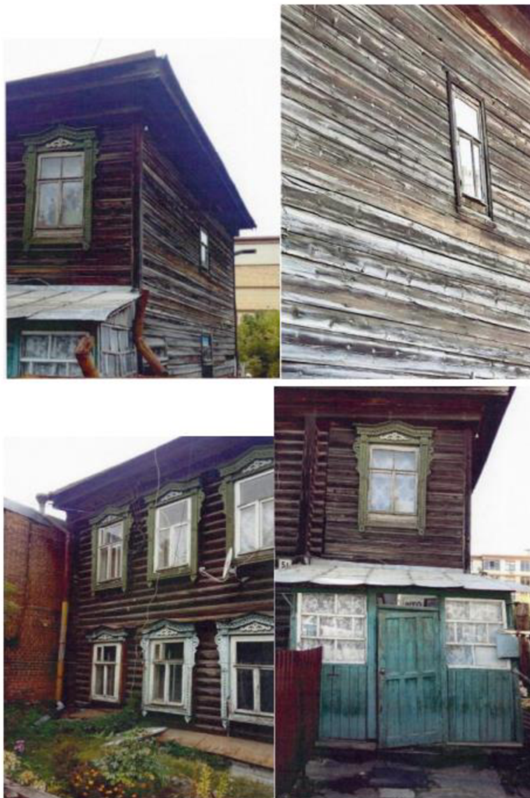
Рисунок 2 – Фотографии фрагментов с характерными дефектами
