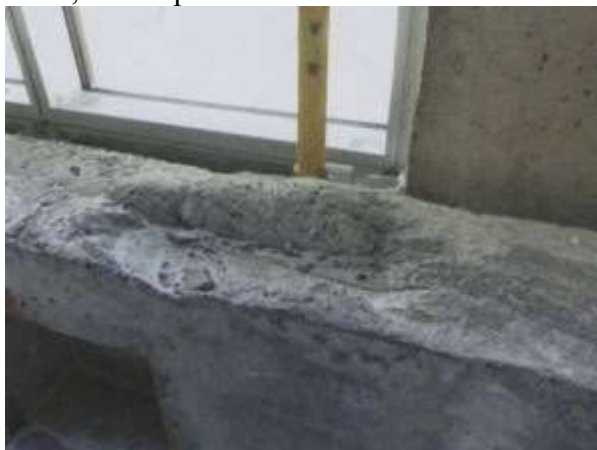
Рисунок 6. Наплывы бетона с нарушением геометрии конструкции
