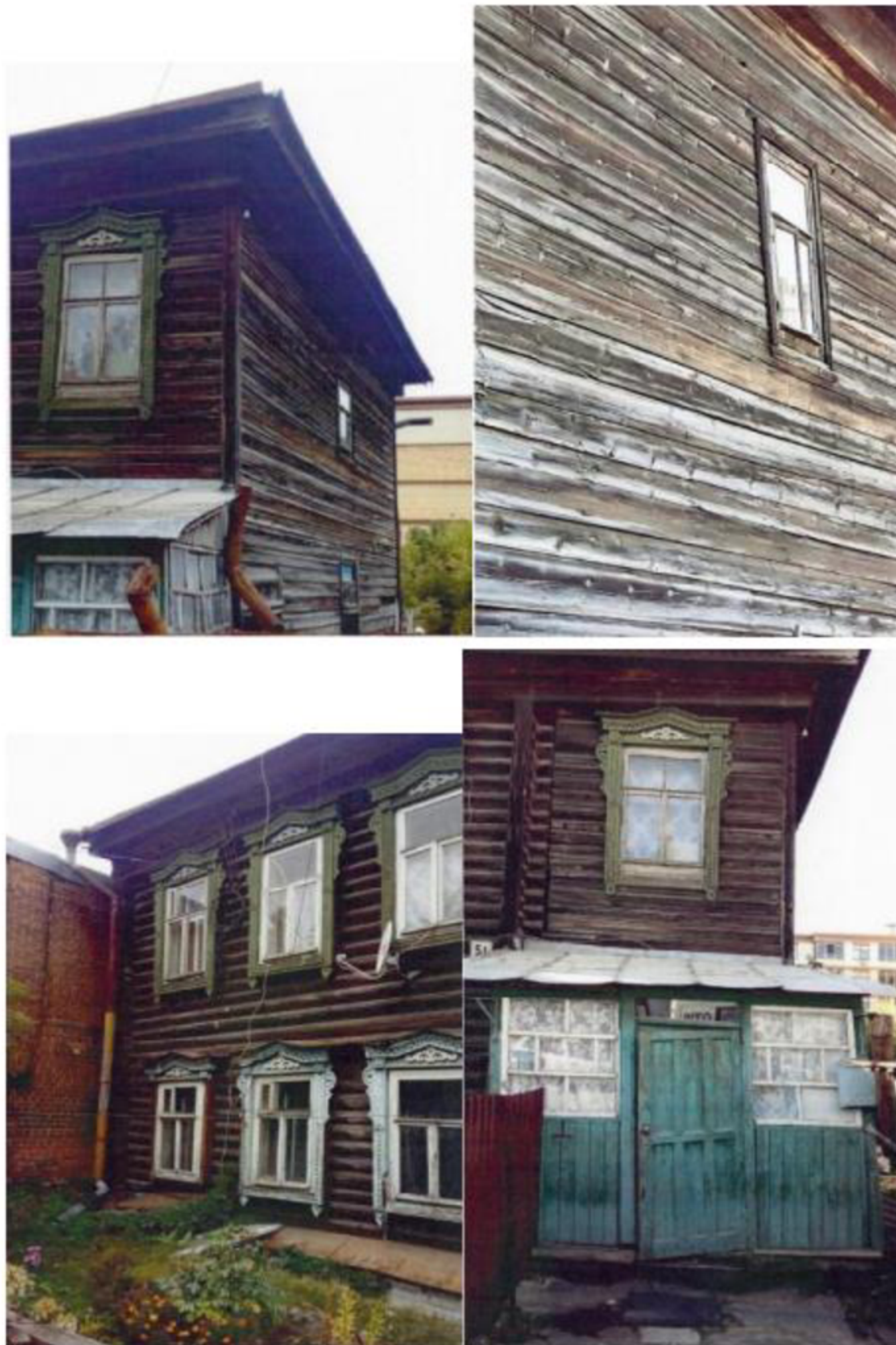
Рисунок 2 – Фотографии фрагментов с характерными дефектами
