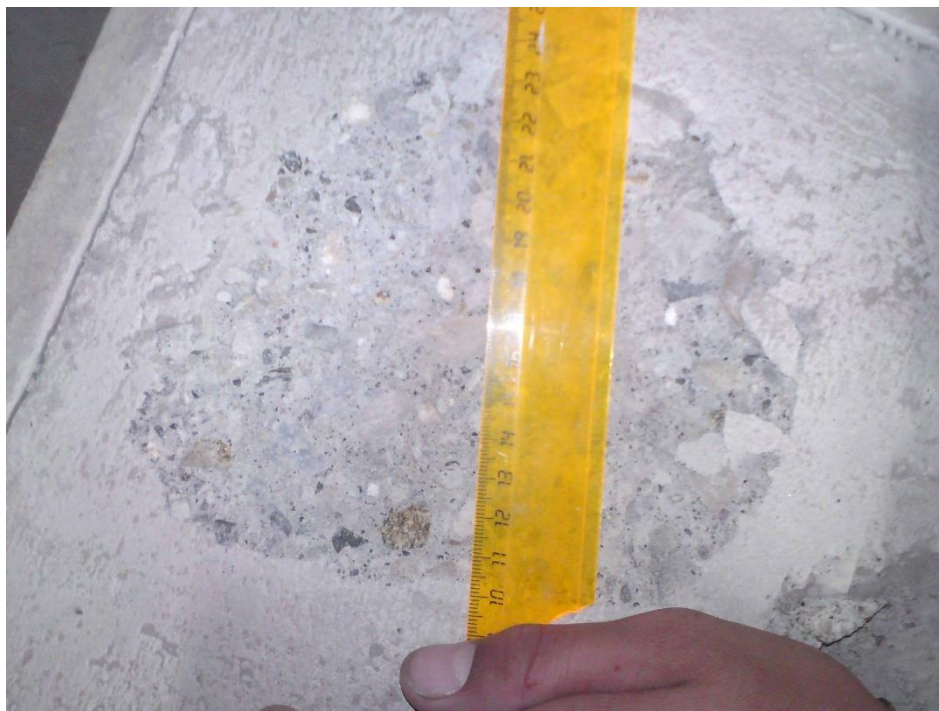
Рис. 4.6.4. Измерение площади отрыва бетона
