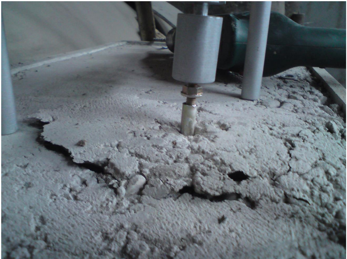
Рис. 4.6.2.. Момент отрыва бетонного конуса из тела конструкции
