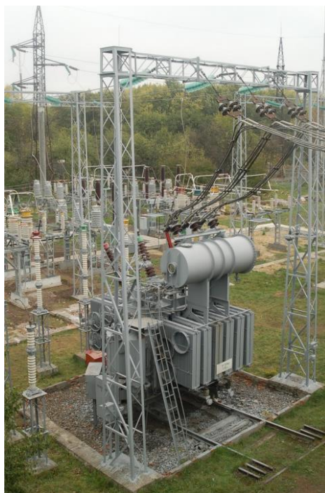
Рисунок 6 Силовой трансформатор и открытое распределительное устройство подстанции
