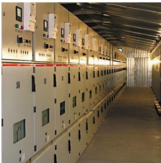
Рисунок 4 ЗРУ комплектующее шкафами КРУ
