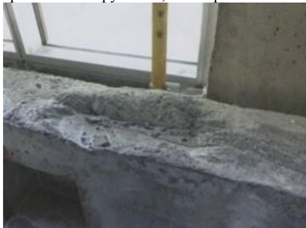
Рисунок 6. Наплывы бетона с нарушением геометрии конструкции
