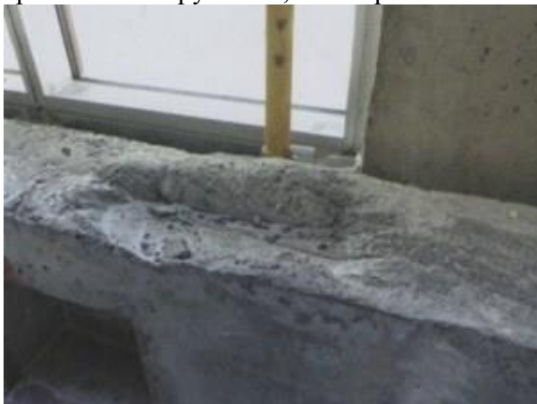
Рисунок 6. Наплывы бетона с нарушением геометрии конструкции
