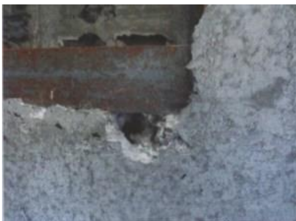
Рисунок 2а. Непровибрированные участки с образованием каверн под металлической балкой
