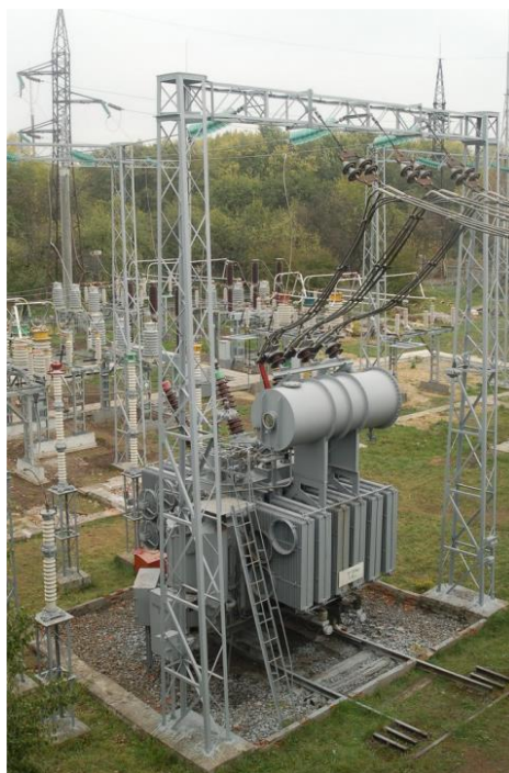
Рисунок 6 Силовой трансформатор и открытое распределительное устройство подстанции
