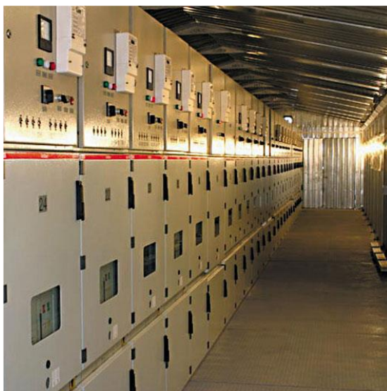
Рисунок 4 ЗРУ комплектующее шкафами КРУ
