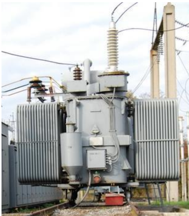
Рисунок 5 Силовой трансформатор подстанции
