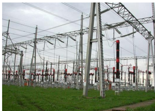
Рисунок 2 –Открытые распределительные устройства Закрытые распределительные устройства
