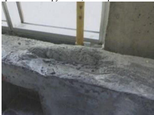
Рисунок 6. Наплывы бетона с нарушением геометрии конструкции
