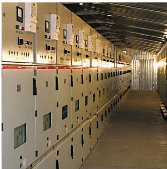
Рисунок 4 ЗРУ комплектующее шкафами КРУ
