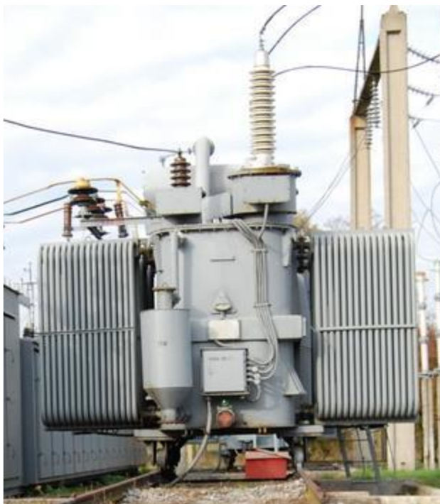
Рисунок 5 Силовой трансформатор подстанции
