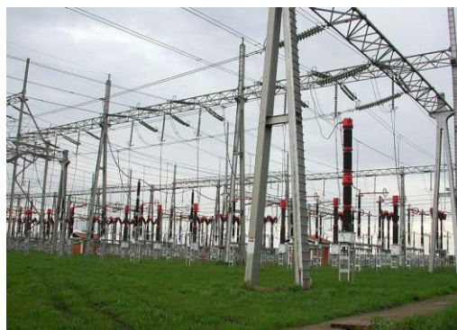
Рисунок 2 –Открытые распределительные устройства Закрытые распределительные устройства
