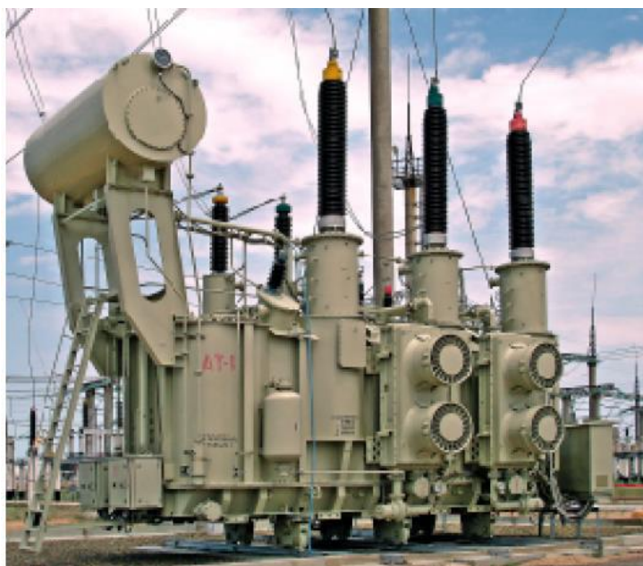
Рисунок 7 Автотрансформатор с системой охлаждения с дутьем и принудительной циркуляцией масла через воздушные охладители с вентиляторами
