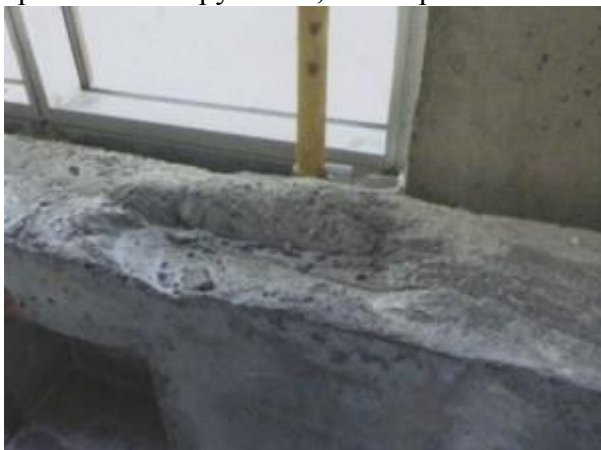
Рисунок 6. Наплывы бетона с нарушением геометрии конструкции
