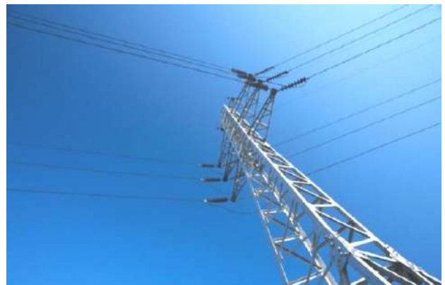
Рисунок 5.5 – Угловая опора 220 кВ
