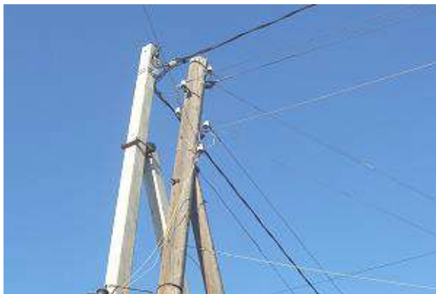
Рисунок 5.4 – Угловая опора 0,4 кВ
