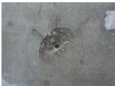
Рисунок 1а. Скол бетона с оголением и коррозией рабочей арматуры
