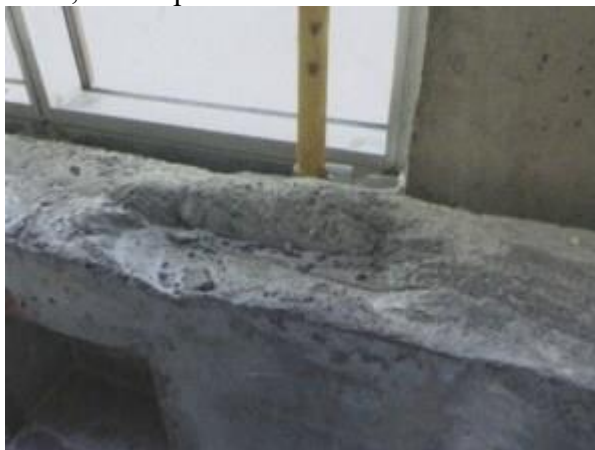
Рисунок 6. Наплывы бетона с нарушением геометрии конструкции
