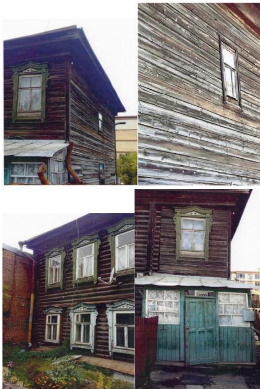
Рисунок 2 – Фотографии фрагментов с характерными дефектами
