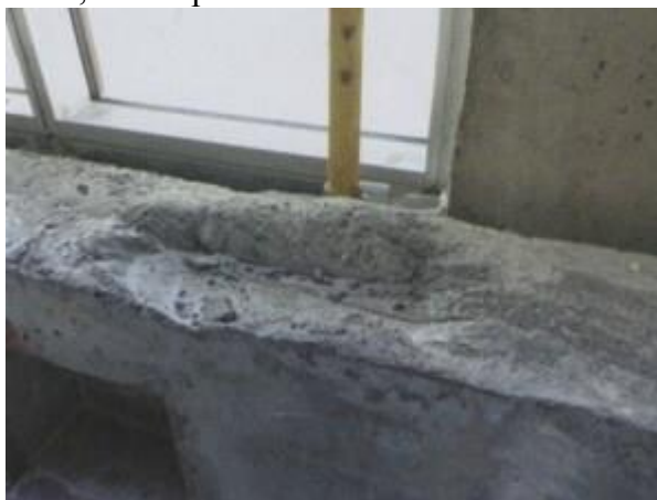
Рисунок 6. Наплывы бетона с нарушением геометрии конструкции
