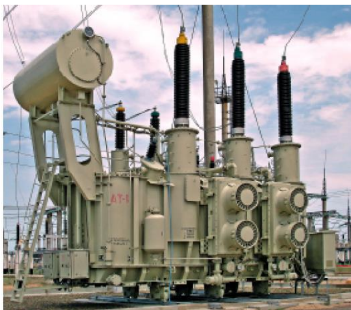
Рисунок 7 Автотрансформатор с системой охлаждения с дутьем и принудительной циркуляцией масла через воздушные охладители с вентиляторами
