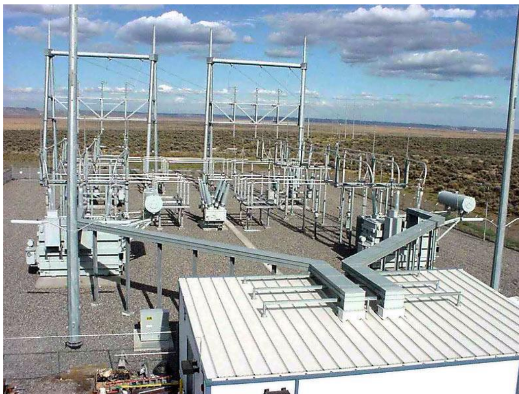
Рисунок 1 На заднем плане открытое распределительное устройство, на переднем здание закрытого распределительного устройства. Цифрами обозначены: 1 портал; 2 силовой трансформатор; токопровод для передачи электроэнергии от силового трансформатора в закрытое распределительное устройство; 4 разъединитель; 5 выключатель
