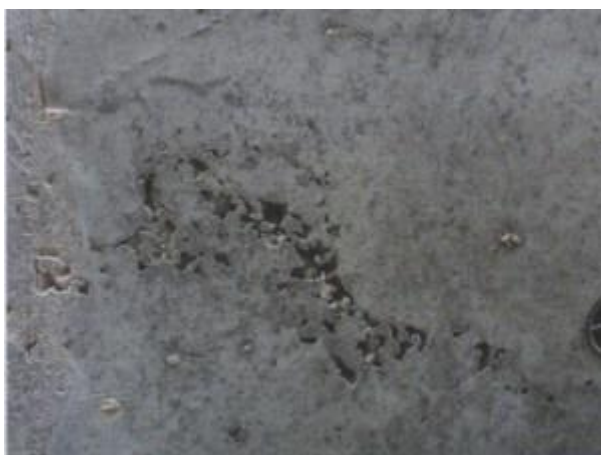
Рисунок 2б. Непровибрированные участки с образованием каверн под металлической балкой
