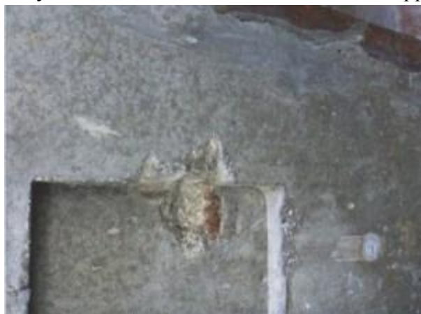
Рисунок 1б. Скол бетона с оголением и коррозией рабочей арматуры
