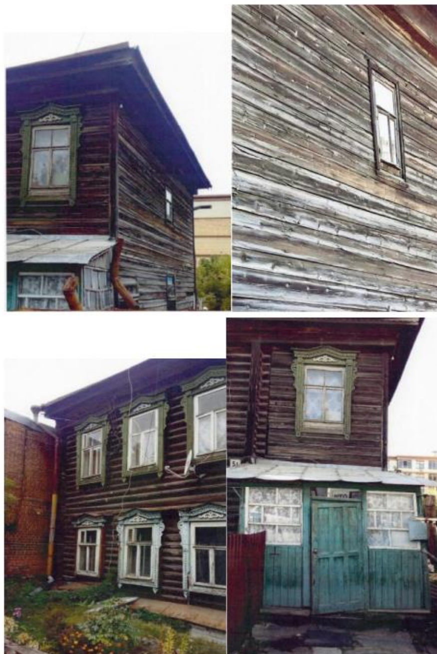
Рисунок 2 – Фотографии фрагментов с характерными дефектами
